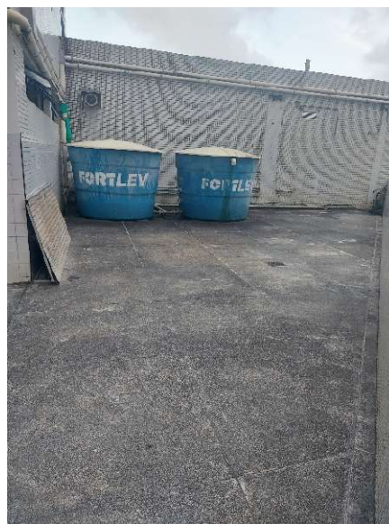
CAPTAÇÃO DE ÁGUA DE CHUVA
